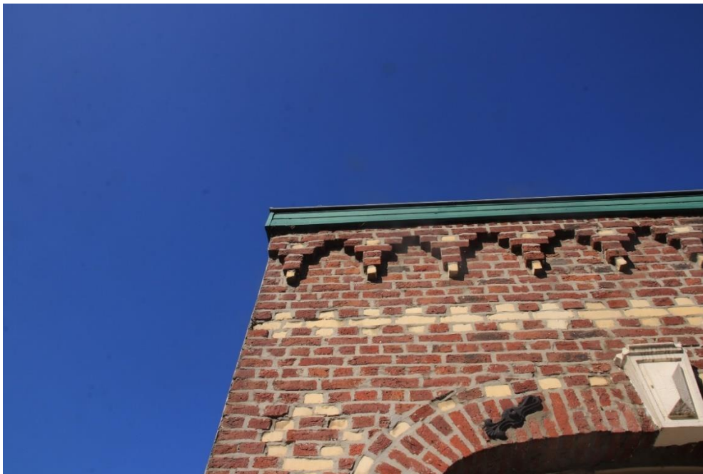
Foto 2: er zijn geen geschikte invliegopeningen voor vleermuizen in het pand (de dakgoot lijkt toegankelijk, maar de donkere rand betreft schaduw van de zon)
